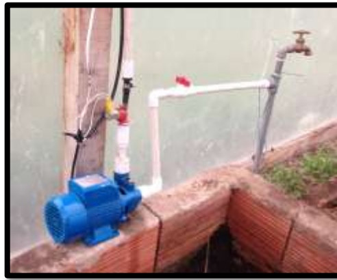
Ilustración 14. Registro fotográfico Segunda conexión Motobomba y electroválvula principal.
