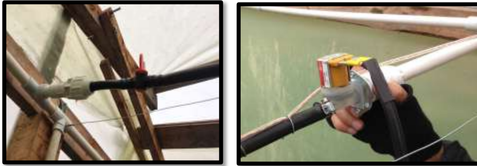
Ilustración 15. Registro Fotográfico Conexiones válvulas de líneas de riego. Izquierda: Conexión Válvula mecánica. Derecha: Conexión Electroválvula.
