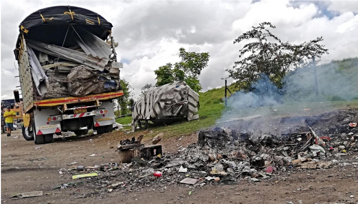
Acumulación de escombros, Villa Cindy, 2021. Fotografía: Viviana Bocanegra
