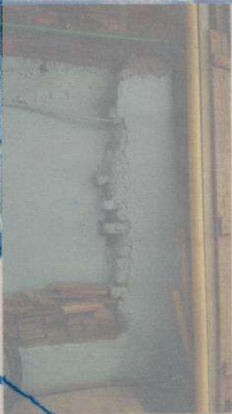
Imagen 18 Fotografía. En transparencia, la grieta de la otra casa. Fuente. Archivo personal. Año 2020.
