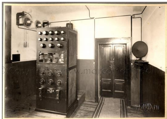
Ilustración 7. Sala de Transmisión con equipos de Western Electric.
