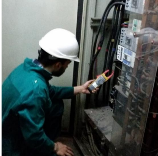
Toma de datos corriente eléctrica (Elaboración propia)
