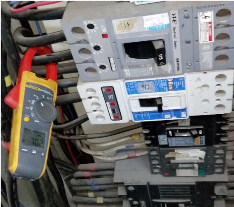
Toma de datos corriente eléctrica (Elaboración propia)
