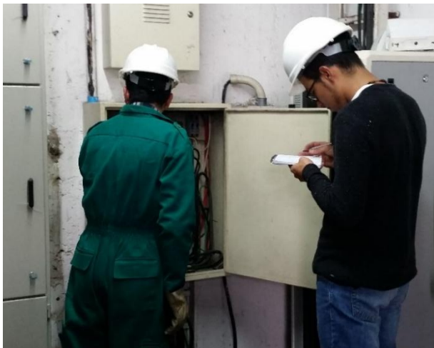
Toma de datos corriente eléctrica (Elaboración propia)
