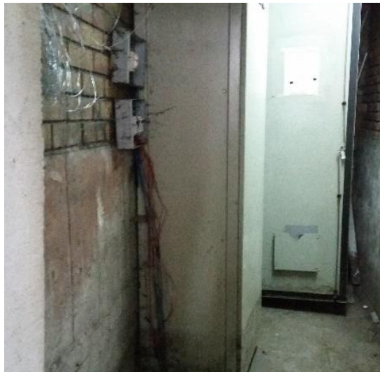
Subestación eléctrica (Elaboración propia)
