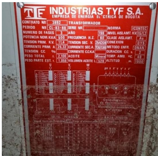
Subestación eléctrica (Elaboración propia)
