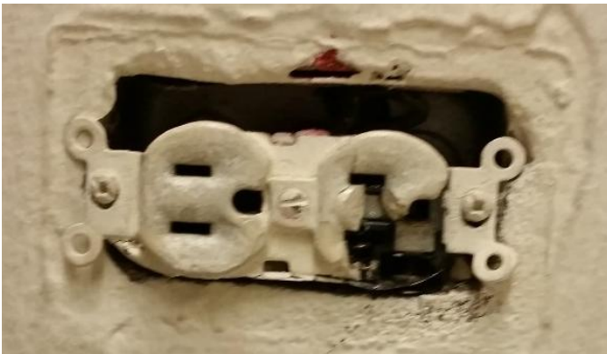
Tomacorriente quemado (Elaboración propia)
