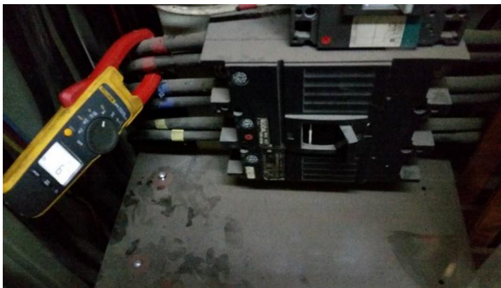
Toma de datos corriente eléctrica (Elaboración propia)
