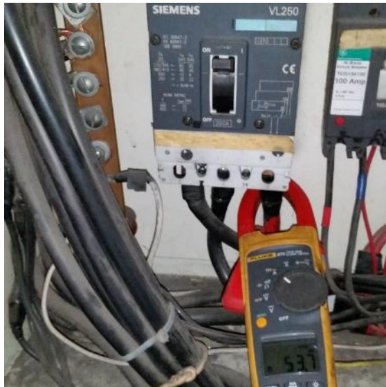
Toma de datos corriente eléctrica (Elaboración propia)
