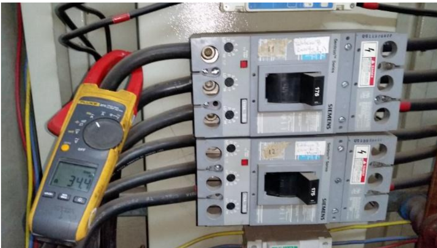
Toma de datos corriente eléctrica (Elaboración propia)
