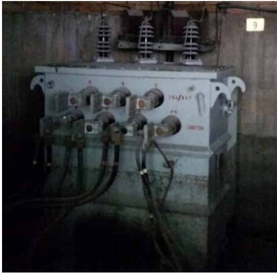
Subestación eléctrica (Elaboración propia)
