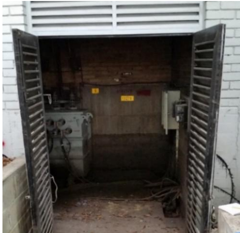
Subestación eléctrica (Elaboración propia)
