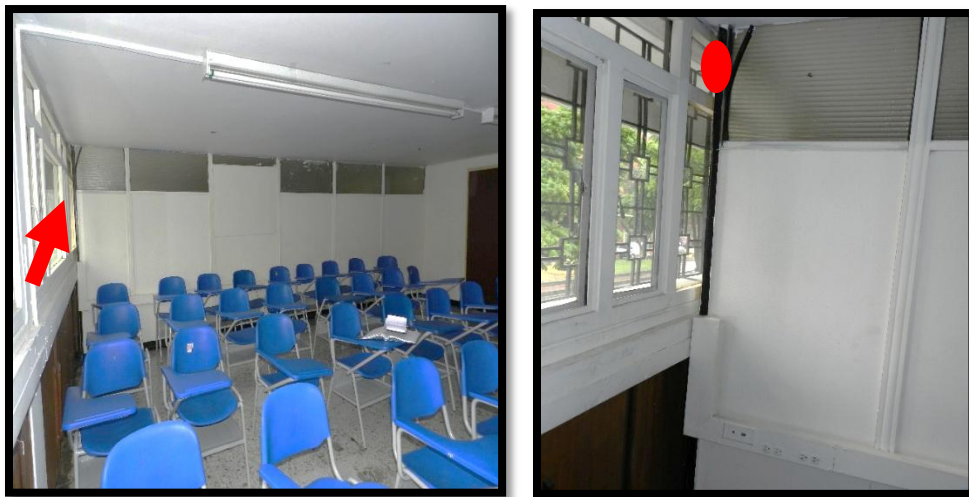
● Espacios de aire entre la pared que divide el aula C291 y C220, y la pared de fachada ubicada el extremo de la calle 72.
