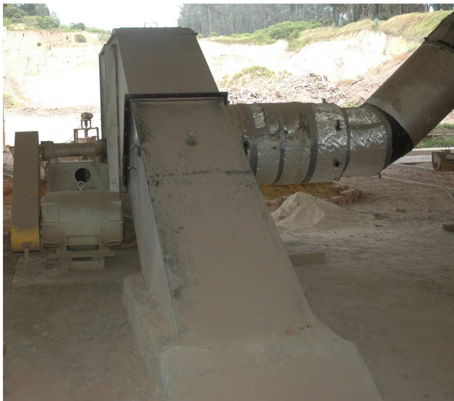
Imagen 64. Ventilador de recuperación. 2017.
